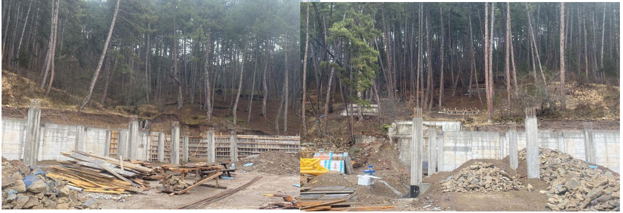
Foto-3,4: “789 ada, 1 ve 2 parsellerde” Kızılcahamam Belediyesince Yapılan Kaçak İnşaat
