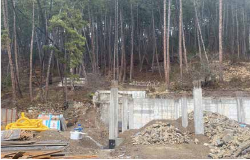
Foto-3,4: "789 Ada, 1 ve 2 Parsellerde" Kızılcahamam Belediyesince Yapılan Kaçak İnşaat
